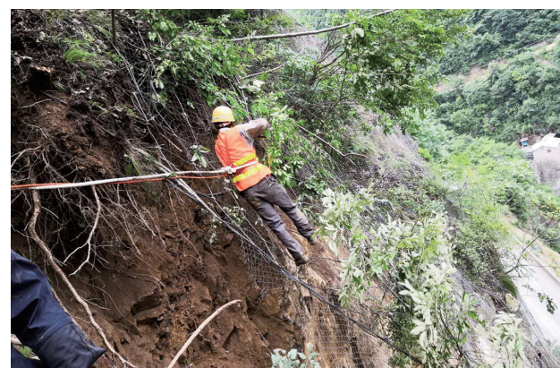
7月1日5时30分,309省道略阳境内K52+820处山体受强降雨影响局部垮塌,导致交通中断。略阳公路管理段立即启动抢险预案,组织党员小分队和抢险队伍紧急赶赴现场,火速对塌方现场进行抢通清理。经过3个多小时紧急抢险,11点30分该路段恢复通行。 通讯员 徐立生 杨镇军 张科 摄
