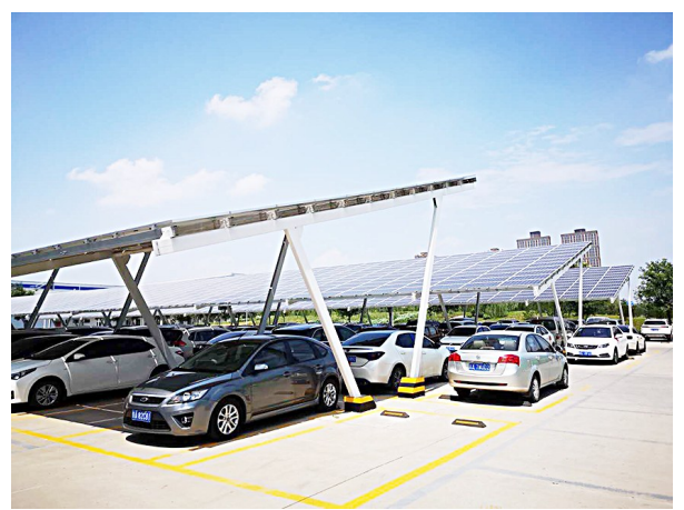
西安重装集团渭源新城20MWp分布式光伏项目,除了利用既有厂房建筑屋顶发电,连停车场也充分利用。这样的停车场既可以利用太阳能光伏发电,又可以避免车辆暴晒,一举两得。 王英楠 摄
