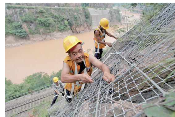
中国铁路西安局集团公司宝鸡工务段充分利用近期连续晴好天气,对山体孤危活石病害进行全面整治,提升设备防洪抗汛能力。图为宝鸡工务段坪头桥隧工区职工在整修山体主动防护网。 杨晓文 摄
