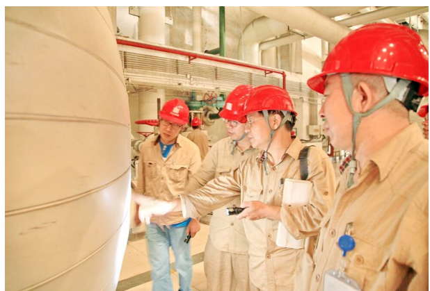
10月11日,运城发电公司组织安监部、发电部、设备部相关人员对制氢站、氨站等各项设施进行“会诊性安全巡视”,打造“平安秋检”,做到有问题早发现、早处理、早预防,为机组迎峰度冬提供了坚实的安全保障。 王燕燕 摄
