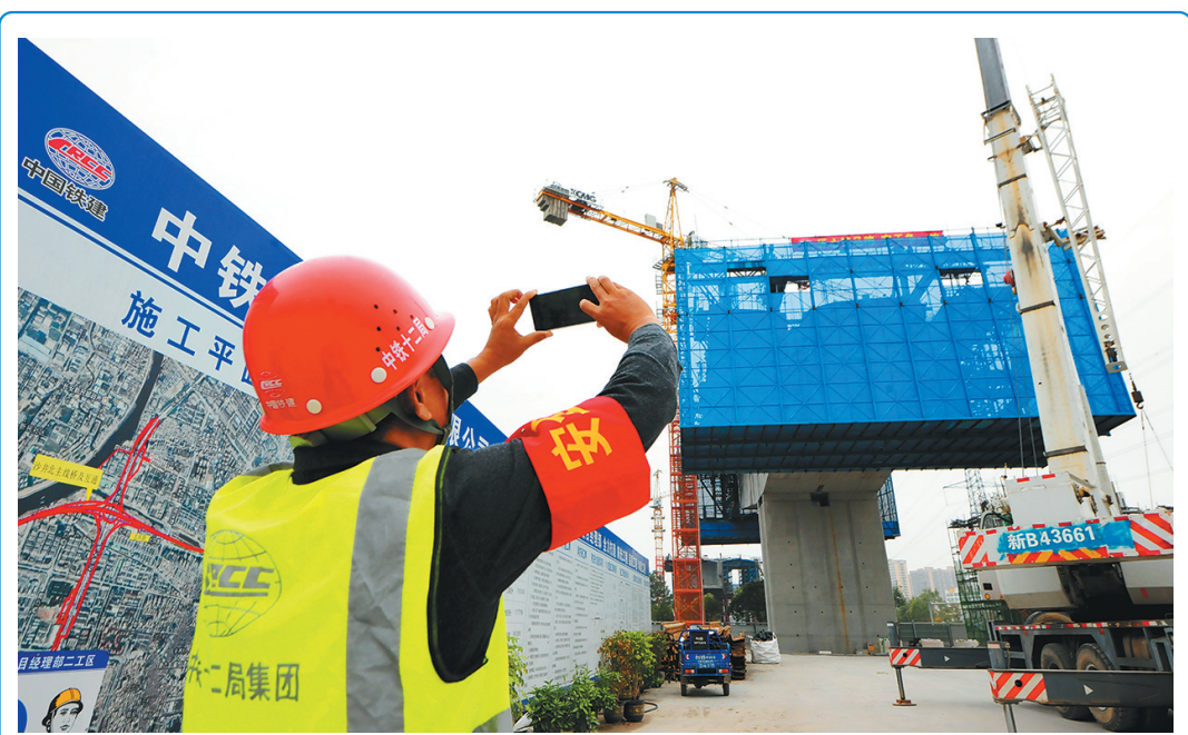
11月25日,由中铁十二局承建的深圳外环高速公路深圳段二期2标段田园互通立交桥,位于沙井新区中心,跨越北环路、松福大道等六条城市主干道,车流量大,安全风险极高。项目部采用集装箱式防护挂篮施工硬件措施,同时在现场醒目处
