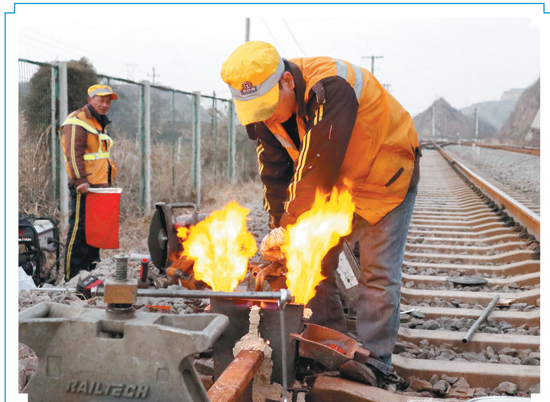
近日,中国铁路西安局集团公司阎良工务段深入开展“大干50天,冲刺目标值”增运补欠攻坚战活动,严控安全关键,强化隐患排查,加大设备整修,确保各项目目标任务期到必成。图为该段职工正在进行铝热焊作业。
