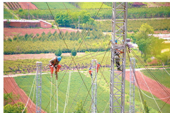
5月1日,在西安市蓝田县境内,由陕西送变电工程有限公司负责施工的宝鸡-西安南-信义II回750千伏线路工程,提前4小时完成跨越G40沪陕高速公路的跨越施工,解除四级安全风险,为“五一”小长假人们出行让“路”。图为施工人员正在拆除跨越G40高速公路导地线的施工跨越架。 高浪舟 摄
