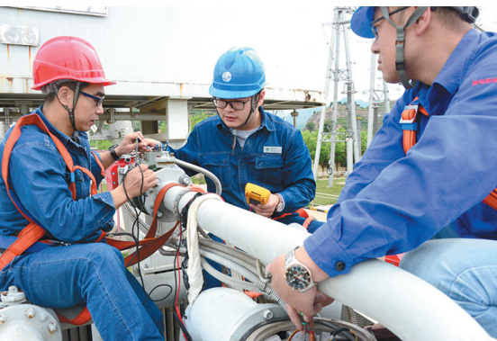
5月30日,国网商洛供电公司张村330千伏变电站一号主变保护进行定期检修,并对一号主变消防装置防误改造和三侧设备检测测试,消除主变设备缺陷,确保电网设备顺利迎峰度夏。余发金 摄
