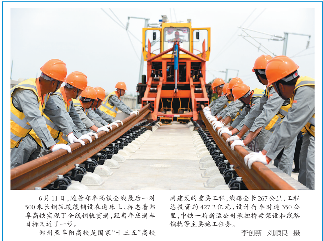
6月11日,随着郑阜高铁全线最后一对500米长钢轨缓缓铺设在道床上,标志着郑阜高铁实现了全线铺轨贯通,距离年底通车目标又近了一步。 郑州至阜阳高铁是国家“十三五”高铁网建设的重要工程,线路全长267公里,工程总投资约427.2亿元,设计行车时速350公里,中铁一局新运公司承担桥梁架设和线路铺轨等主要施工任务。 李创新 刘顺良 摄
