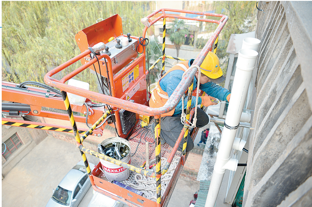
12月7日,西安市咸宁中路普天小区自来水水管网分户供水改造正在进行。这是根据西安市“三供一业”维修改造工作的部署,市自来水公司进行的自来水改造施工。以实现供水“一户一表、分户计量”,今后通过手机支付就可以交水费。王忠义 摄
