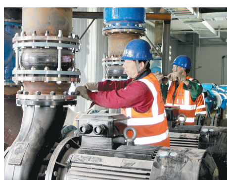
自复工复产以来,在西安航天基地单晶硅电池厂工地,承担施工的陕建一建集团安装公司,工人们抢时间抢进度,抓紧各种管线的安装。
