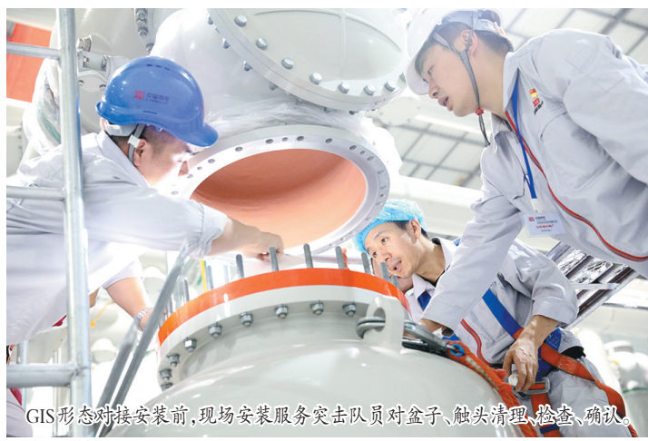
GIS形态对接安装前,现场安装服务突击队对盒子、触头清理、检查、确认。
