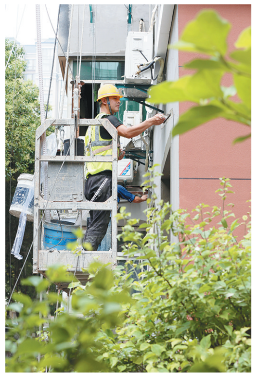
中建七局四公司工作人员对谭家小区老旧小区外墙进行翻新。
