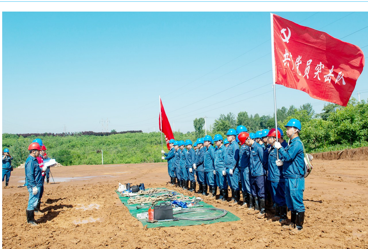
6月18日,连日降雨致使商洛市洛南县城关镇王塬社区某施工场地发生滑坡,致使110千伏四丰Ⅰ线7号杆和四丰Ⅱ线8号铁塔处于滑坡体中,将造成县城大面积故障停电
