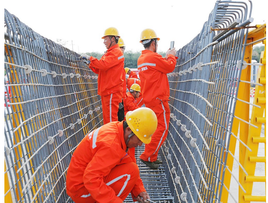
日前,陕西省交通运输厅对全省12个今年通车高速公路项目进行通报,中国铁建投资集团投资建设的合铜高速项目排名第一。截至目前,合铜高速项目95公里主线路基已完成63公里交验。图为工人在进行预制箱梁钢筋绑扎作业。李伟功 陈凯 摄
