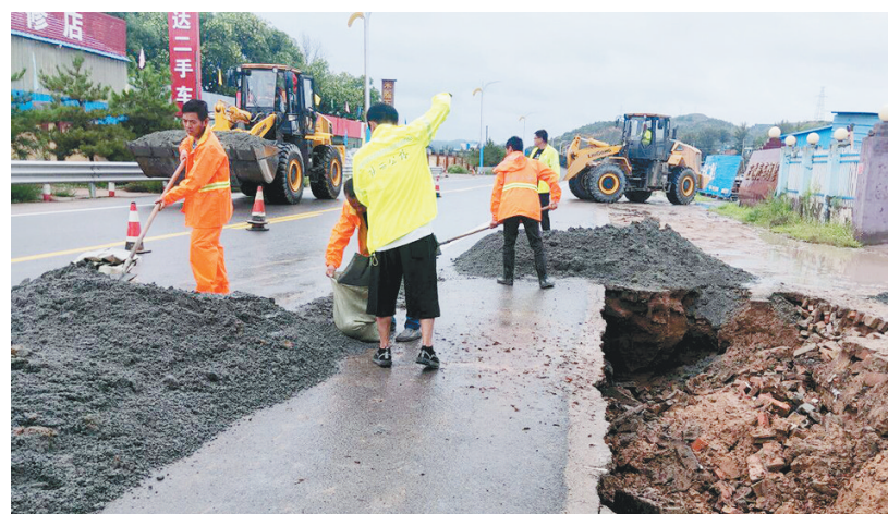
↑近日,米脂县境内迎来持续强降雨天气,榆林市米脂公路段积极应对,立即启动应急抢险预案,全力做好公路安全防汛保畅抢险工作。图为对被冲毁路段的路面路基进行临时防护。姬腾腾 摄
