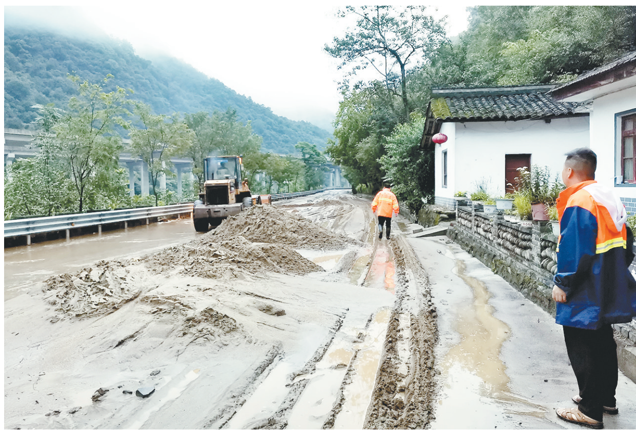
↑8月7日夜,汉中市留坝县普降大到暴雨,境内244国道遭受重创,塌方、泥石流30多处6000余立方米,交通中断。留坝公路段50多名职工和10台机械设备马不停蹄,连续奋战,于8日凌晨实现交通单边通行。徐立生 李振源 摄
