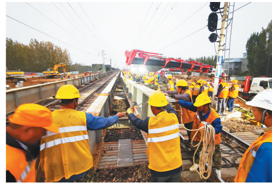
近日,随着京广线上行线最后一根纵梁吊装就位,中铁电气化局铁路工程公司承建的许昌市建安区新元大道下穿京广铁路立交工程纵梁吊装施工全部完成。图为施工人员进行吊装作业。
