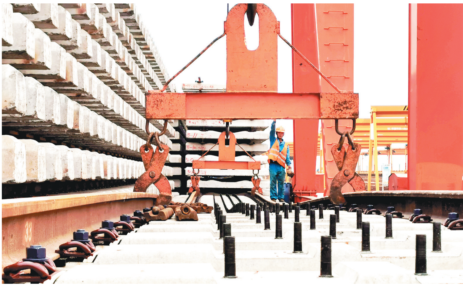
中铁一局新运公司玉磨项目部,在中老铁路国内玉磨段铺架施工中,针对技术工人短缺的问题,立足于“自产”,积极为员工成才搭建平台,通过技术比武、岗位练兵、技能竞赛、技术交流培训等形式,提高员工的素质。图为近日的比武现场,员工进行轨排吊架堆垛比赛。 □刘顺良 摄
