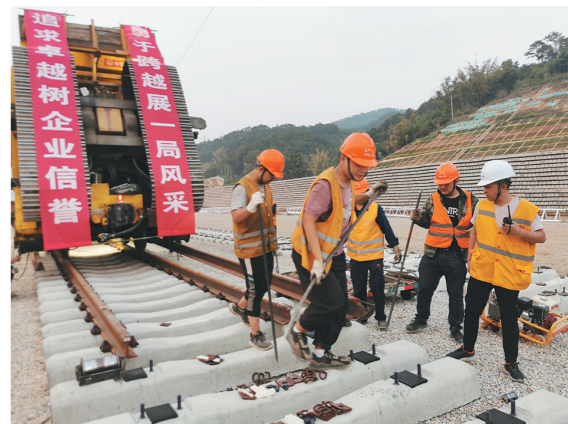
4月1日,中铁一局玉磨铁路铺架项目部铺轨顺利到达云南省普洱市宁洱车站,实现全线铺轨过半及标段内玉溪至大金山隧道进口段的T梁架设任务,距离全线铺轨完成和开通运营又进了一步。 □刘顺良 陈高原 摄
