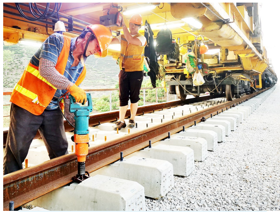
日前,担负中老铁路国内玉(溪)至磨(憨)段全线铺轨任务的中铁一局,克服铺架施工中重重困难,在工期紧、任务重的情况下,项目部精心组织、合理安排,多次优化铺轨施工方案,采用两台国内先进CPG500铺轨机,四班工人昼夜施工,使铺轨进度不断向前延伸。 □刘顺良 摄
