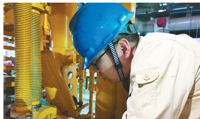
6月22日,陕西国电锦界能源有限责任公司顺利完成3号机EH油净油机排油泵检修工作。目前该厂上下联动主动出击,及时消除设备隐患和缺陷,助力机组迎峰度夏。 □刘治军 摄
