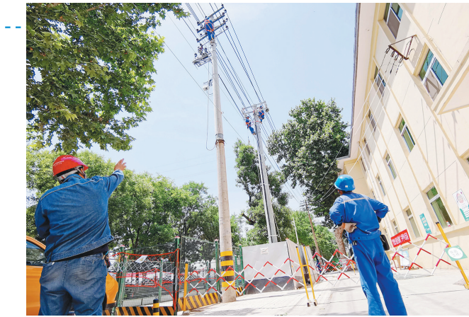
十四运会召开在即,西安市阎良区负责承办滑板、攀岩两个赛事,为保障两个运动场馆的可靠用电,近日,由阎良供电公司牵头对北堰开闭所、174市北二线以及175市北线的自动化改造全面告捷,场馆供电线路实现自动化。 马珍 摄
