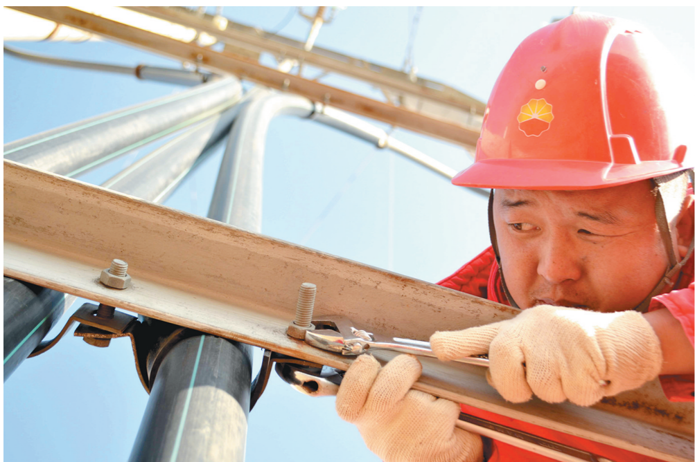
12月13日,榆林市靖边县大路沟镇积雪还未融化,气温骤降至零下5度。长庆油田新能源项目部职工在巡查中发现,安盘二回35千伏电缆出线支架的螺丝有松
