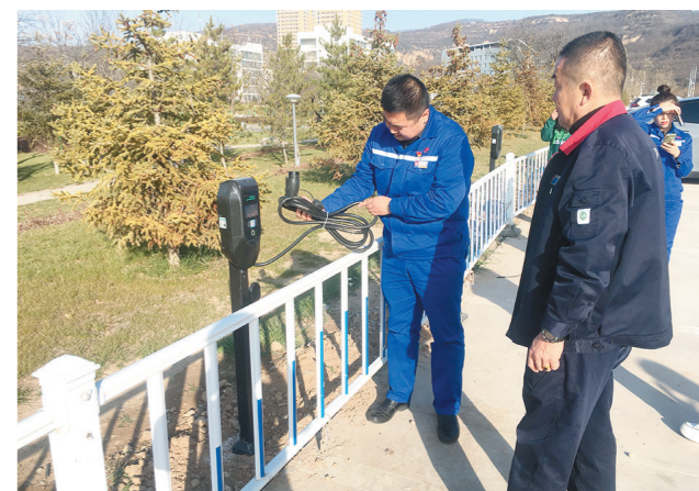
近日,为满足广大职工电动车充电需求,杜绝安全隐患,延长石油延安炼油厂后勤保障部在各生活区安装“智慧、安全、便捷”的智能充电桩。目前,5个生活小区已安装13台充电桩主控设备,合计230个插座终端,解决了职工电动车充电问题。 □曹锋 杨丹琼 摄
