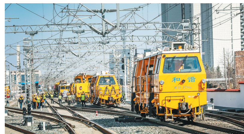
近段时间,中国铁路西安局集团有限公司工务机械段组织抽调了1500余名干部职工,对管内陇海线进行清筛、换轨、打磨、捣固等机械化作业,全面提升线路质量。 □刘刚 摄
