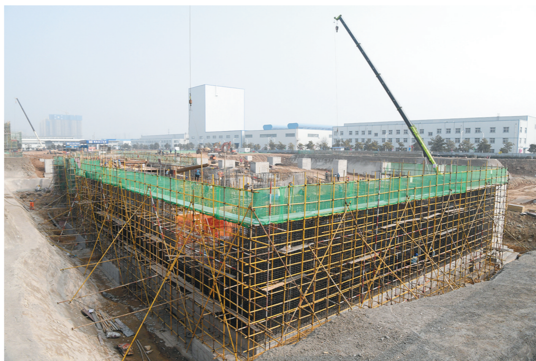
今年以来,宝钛集团有限公司狠抓在建项目进度,力争以项目建设筑牢高质量发展基础。图为该集团建设的宽幅钛合金板材、带箔材项目施工现场。 □王涛 摄
