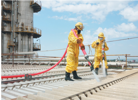
近日,榆林气温迅速上升,延长石油榆林炼油厂制定空冷冲洗方案,保障装置在夏季安全平稳运行。刘常钰 高威 摄
