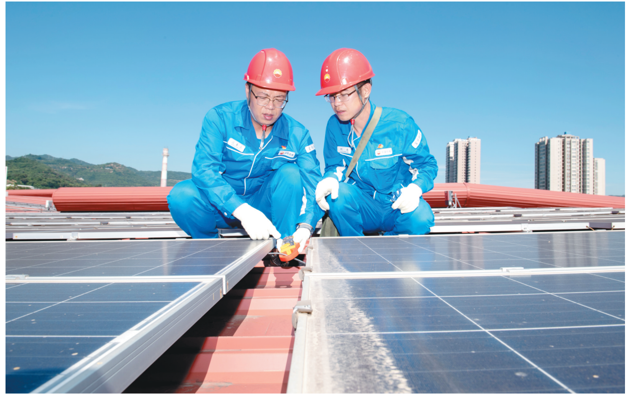
近年来,宝鸡石油钢管有限责任公司围绕“双碳”目标,全面布局光伏、风电、氢能等新能源项目,绿色低碳转型迈出坚实步伐。图为7月5日公司技术人员顶着高温,在厂房楼顶检查光伏设备运行情况。□杨宏智 王成龙 摄
