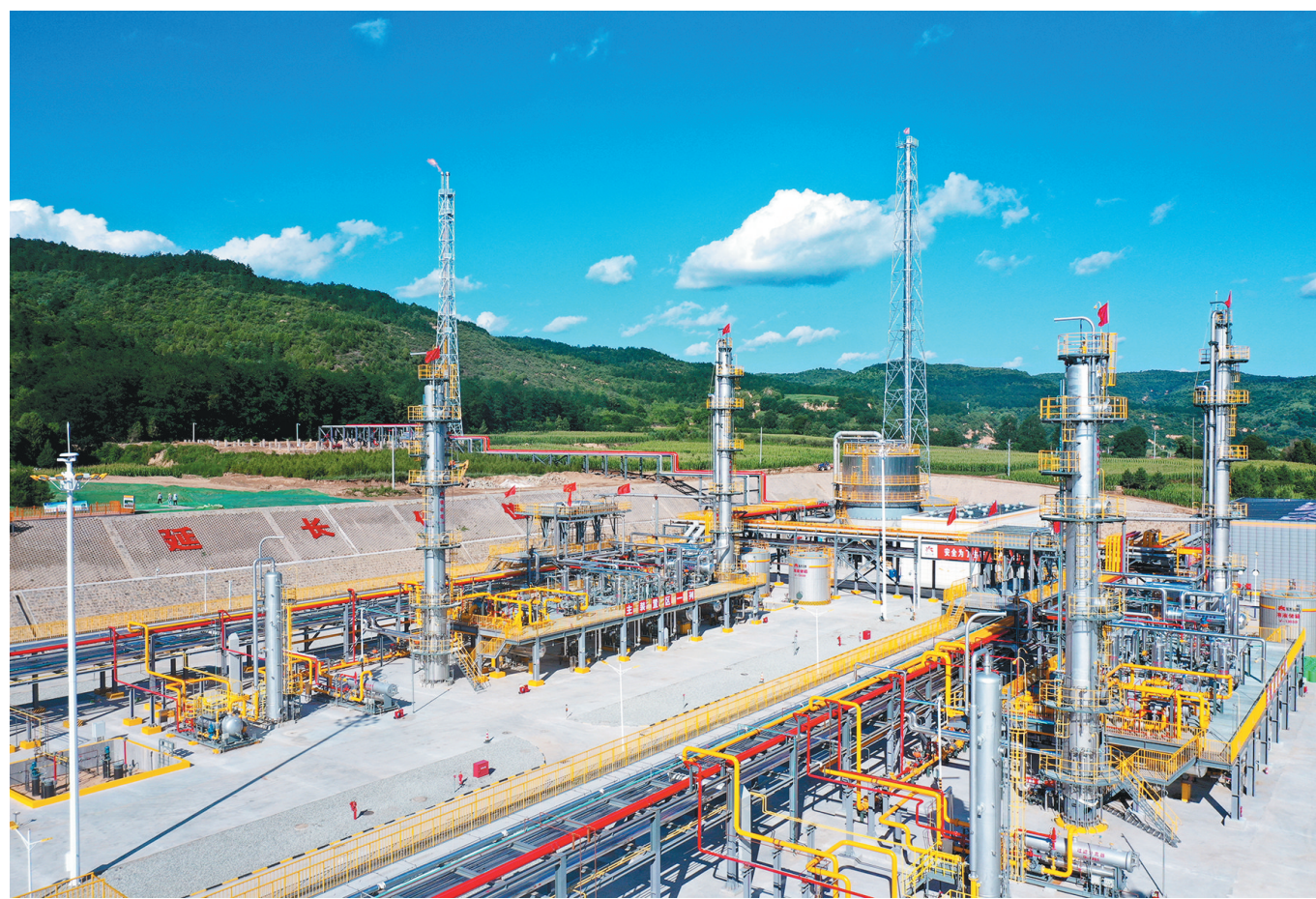
7月20日,延长石油150亿方/年天然气产能建设启动会暨富县一甘泉10亿方/年天然气项目投产仪式上,由陕建安集团承建的富县延694项目直罗净化厂安全平稳进气,火炬点火一次成功,期间设备运行
