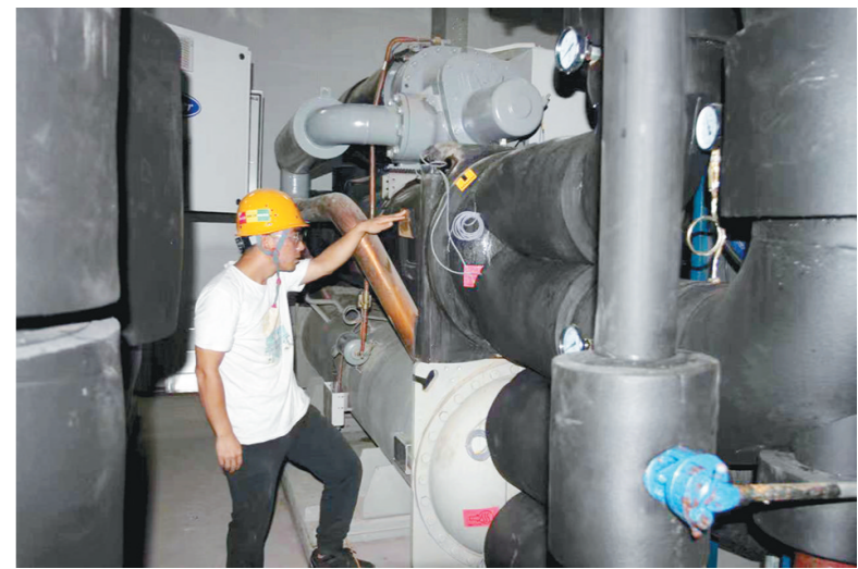
今夏以来,西安持续高温,为确保陕西考古博物馆文物的安全,陕建一建集团安装公司承担了馆内消防喷淋系统、空调制冷系统和其他用水的运行保障任务。图为一名工人检查空调制冷泵的运行情况。 □王维文 摄
