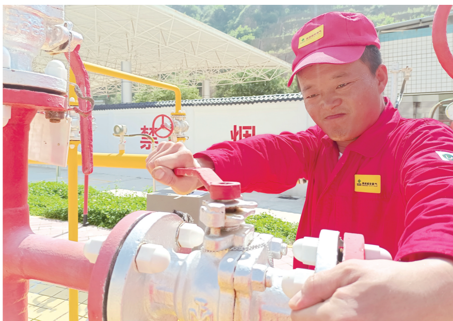
近期,全省多地开启高温模式,面对“烤”验,陕西城市燃气产业发展有限公司干部职工没有停下安全保供的脚步,
