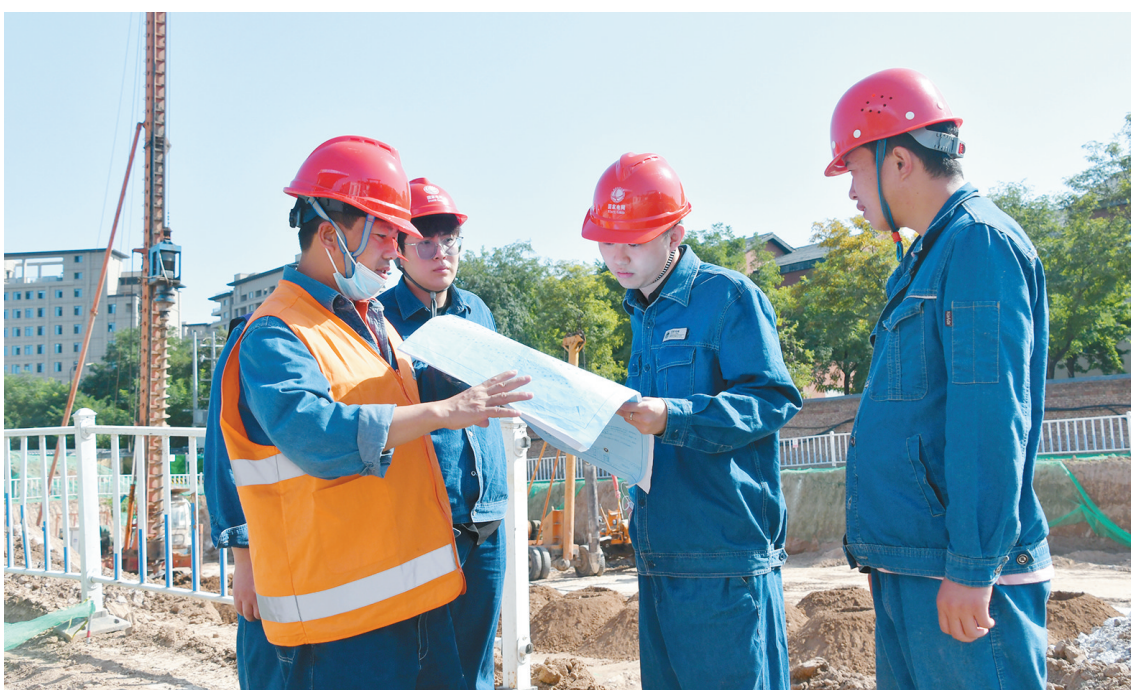
为加快推进临潼区坚强电网建设,破解供电能力“卡脖子”难题,截至9月5日,国网西安供电临潼公司统筹推进区内6项输变电工程及1项送出工程建设任务,优化网架结构布局,缓解高峰负荷期间电网压力,切实保障民生及工农业生产用电。图为工作人员在110千伏芷阳变电站施工现场察看图纸及工程进度。 □潘世策 摄
