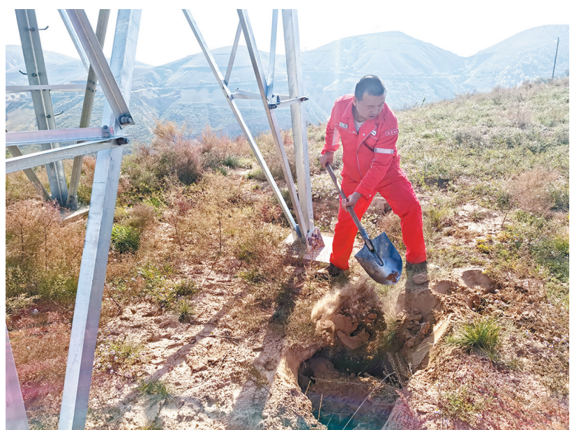
由于前期的强降雨,地处黄土高原的输电线路塔基易出现塌陷,9月13日,长庆油田清洁电力开发项目
