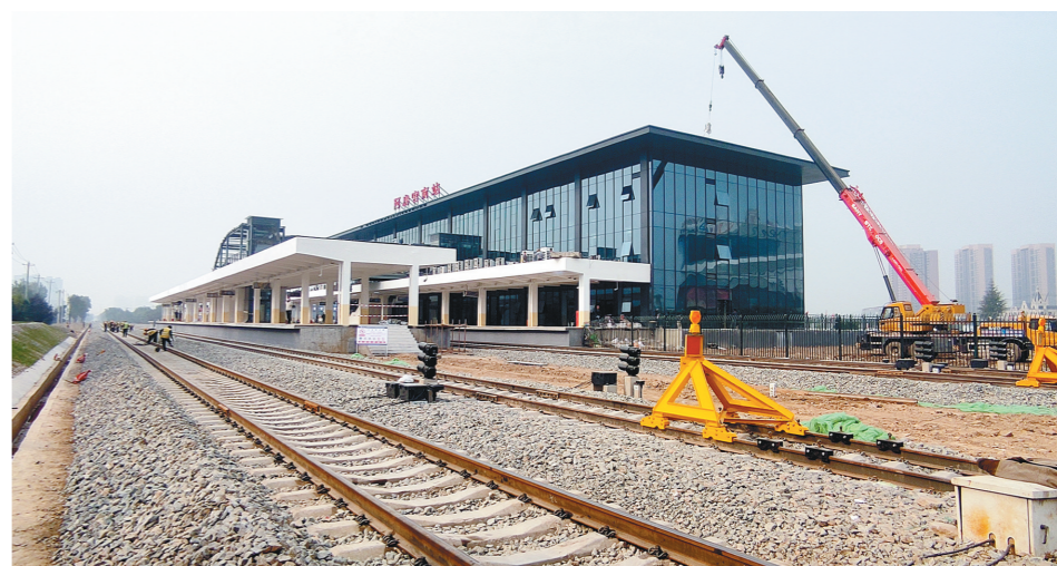
10月24日拍摄的西户铁路提升改扩建阿房宫站现场，工人们正在加快施工进度，以实际行动学习贯彻党的
