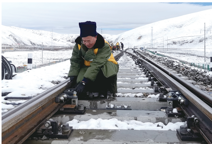
雷继升在检查道岔结合部病害。
