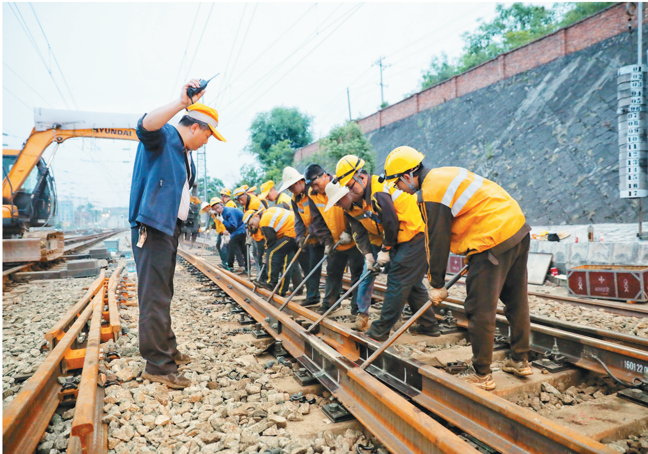
国铁西安局安康工务段以党的二十大精神为引领,严格按照标准作业,科学组织实施,加强对关键人员、关键工序、关键设备的盯控,全力提升线路设备质量。图为11月7日,该段对襄渝下行线安康站内道岔进行更换作业。 □张霖 摄
