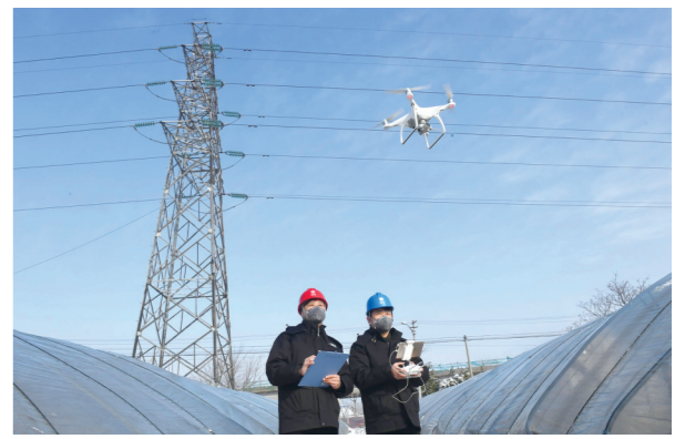
11月28日,国网西安供电临潼公司组织供服二班职工应用无人机巡查,对10千伏线路147号家线进行试点巡查。 □潘世策 袁方 摄
