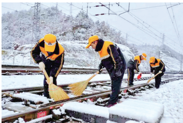
12月1日,国铁西安局安康工务段针对此次降雪加大线路设备检查力度,采取机车添乘、徒步巡查等方式,对管内线路设备进行全覆盖检查。图为该段职工对道岔进行除雪作业。张霖 摄
