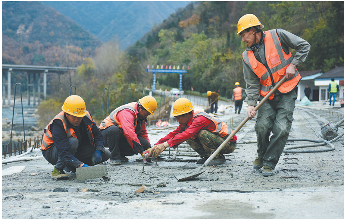
连日来,汉中市公路局244国道留坝县姜子重大水毁应急修复工程在确保安全第一的前提下,继续督促增加人员、设备投入,争分夺秒抢抓进度,确保工程按期目标完工通车。图为施工现场。 □徐立生 摄
