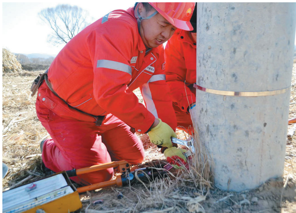
2月3日起,长庆油田清洁电力开发项目部靖边电力大队对重点区域、重点线路进行重点巡视,发现缺陷隐患,及时上报消缺处理,保证了油区生产生活的用电。图为运维一班副班长叶程跪在地上对接地线接头压接。□俱伟 摄
