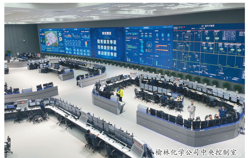
榆林化学公司中央控制室。
