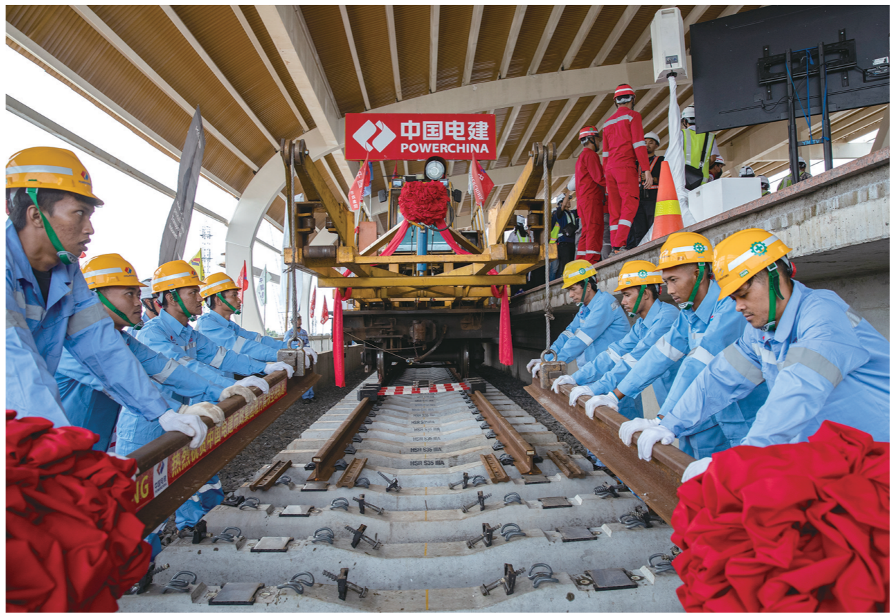
3月31日,在雅万高铁哈利姆车站,工人铺设雅万高铁全线最后一根钢轨。雅万高铁全线轨道铺设仪式当日在印度尼西亚首都雅加达举行,这标志着雅万高铁全线铺轨完成,为高质量开通运营奠定了坚实基础。 □新华社发
