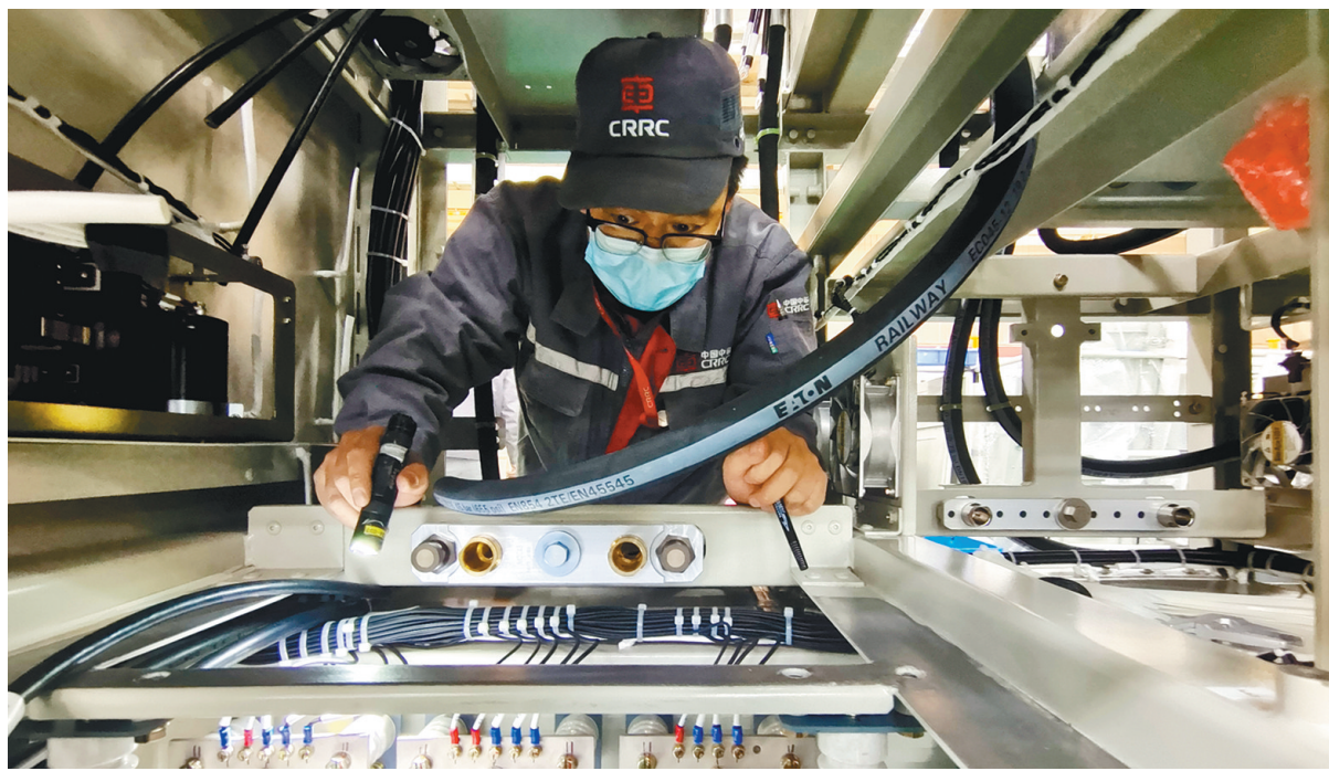
近日,西安中车永电捷通电气有限公司总装车间一派繁忙,工人正在聚精会神组装4400马力内燃机车辅助变流柜。该公司主要从事铁路高速动车组、城市轨道交通车辆牵引系统的设计生产销售及售后服务。随着订单增多,工人加班加点确保产品如期交付,预计销售额比去年增加30%。
