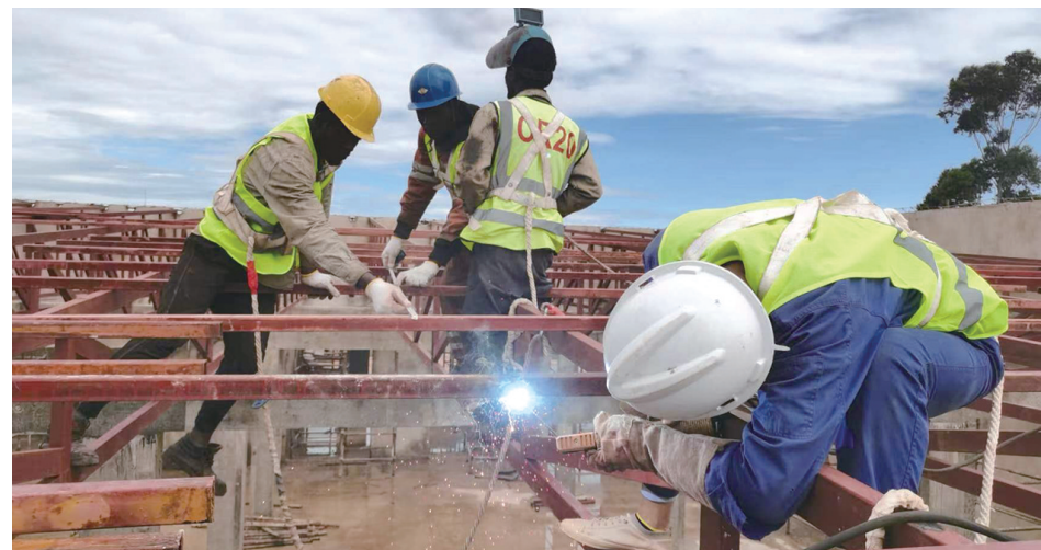
近日,在中铁二十局安哥拉国际公司承建的安哥拉万博省东迪理工教会大学项目现场,参建人员进行电焊。据了解,该项目首次将中国园林式的校园风格搬进西非。 □梁丽萍 摄
