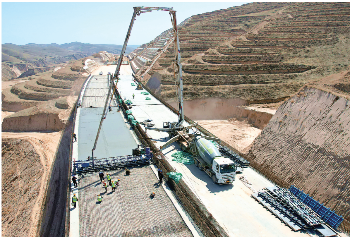
“五一”小长假期间,中铁二十局市政公司广大员工坚守岗位抢抓“施工黄金季”,奋战在市政、房建、公路等工程项目建设一线,铆足干劲抓生产,开
