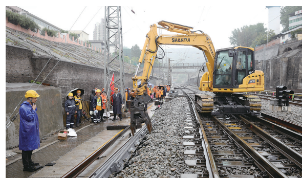
5月6日,国铁西安局安康工务段组织70余名施工人员进行210分钟施工“天窗”,对襄渝铁路万源站30号道岔进行更换。张霖 摄
