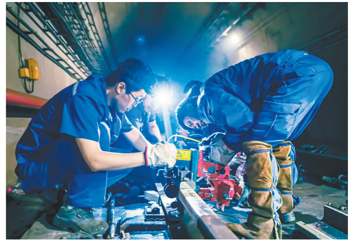
6月28日凌晨，西安市轨道交通集团运营分公司轨道维修部门对5号线青龙寺至理工大学曲江校区下行区间伤损钢轨进行更换。据了解，为保证地铁线路白天正常运营，本次施工严格执行作业标准，保证列车安全平稳运行。 □秦志红 摄
