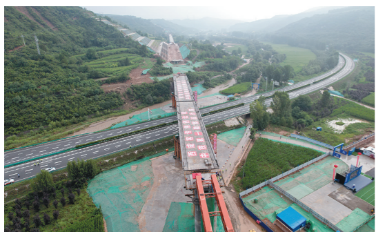
7月29日上午,西延高铁杜村跨包茂高速立交特大桥主跨连续梁成功转体对接,研制运用了国内首个液压马达驱动可重复使用的转体球铰等先进工艺。 文/本报记者 郝佳伟 图/受访者
