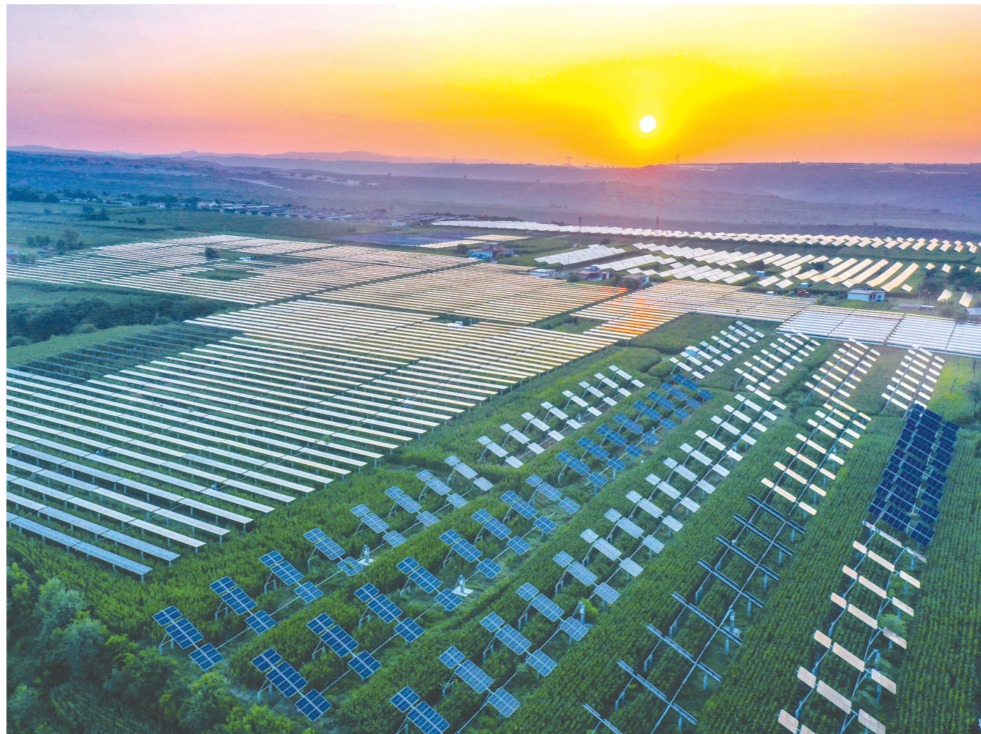
8月4日5时56分,在铜川市宜君县刘家塄光伏发电站,一轮日出冉冉升起,金色余晖洒在光伏板上。该电站占地9600亩,总装机容量250兆瓦,自2020
