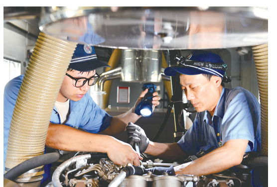
高校开学在即,近日,国铁西安局西安客车站车辆段加大对列车走行部、空调发电机组等的维修力度,全力做好“开学季”学生流运输保障工作。图为职工检修列车空调发电机组。 □赵伯顺 摄
