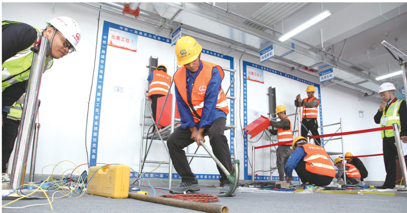
日前,中电一局建安公司第一届“建安工匠”电气安装职业技能比武竞赛在机电分公司西安咸阳机场项目举办,该公司西安地区8家协作队的24名电气安装同台比拼。 □武强 李辰晨 摄
