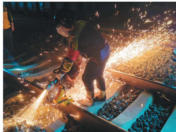
11月28日,西安铁路局延安运营维修段西峡东综合维修车间青年突击队队长韩冬霖,带领突击队队员在浩吉铁路西峡东站内进行更换下行重载伤损绝缘钢轨作业,助力“北煤南运”大通道运输安全畅通。 □通讯员 赵祺凯 摄
