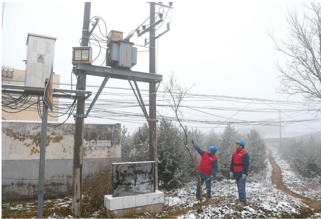
日前,国网西安供电公司辖区普降大雪,穆寨供电所对10千伏136纸李线及0.4千伏线路设备进行雪中巡检,消除线路设备隐患两处,确保山区群众在雨雪天气里安全用电取暖。 □通讯员 潘世策 摄
